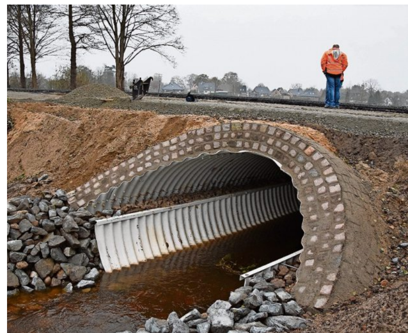
Wo früher die Duxbachbrücke war, gibt es jetzt einen Durchlass unter der Bundesstraße 71.
