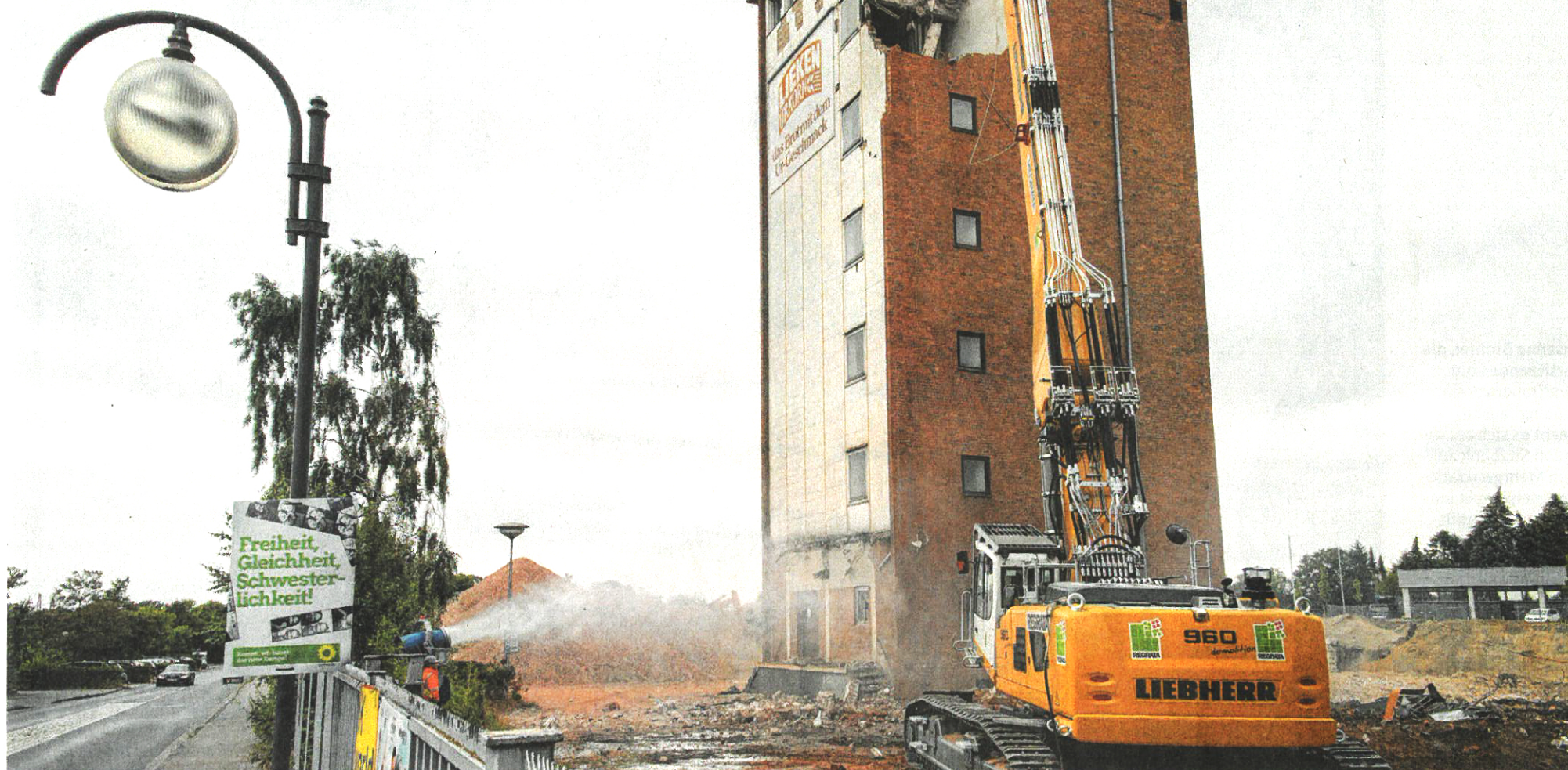
Morgens gegen 9.20 Uhr begann der Bagger am Lieken-Turm zu nagen. Am Vormittag war bereits eine Ecke verschwunden.
