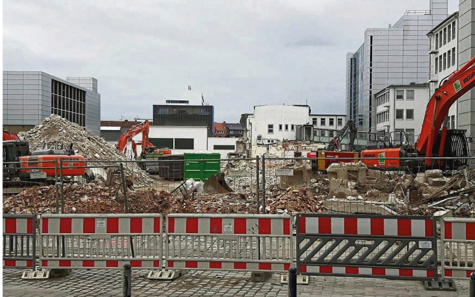
Und los geht's: Die Abriszbagger sind im Einsatz. Auf dem ehemaligen Gewerbeareal zwischen Kleiner Weser und Lucie-Flechtmann-Platz in der Neustadt soll das Projekt „Weserhöfe“ mit rund 300 Wohnungen entstehen. FOTO: ESSER
