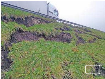
Der abgerutschte Hang an der Apenser Umgehungsstraße soll in den kommenden Wochen wieder in Ordnung gebracht werden Foto: jd
